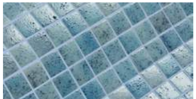
Junta azul claro // Light blue grouting
